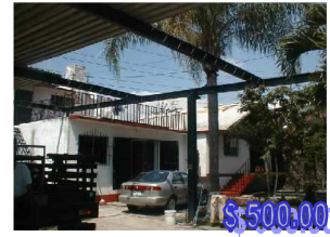
Techumbre de lámina o teja adicionadas a la casa habitación.
